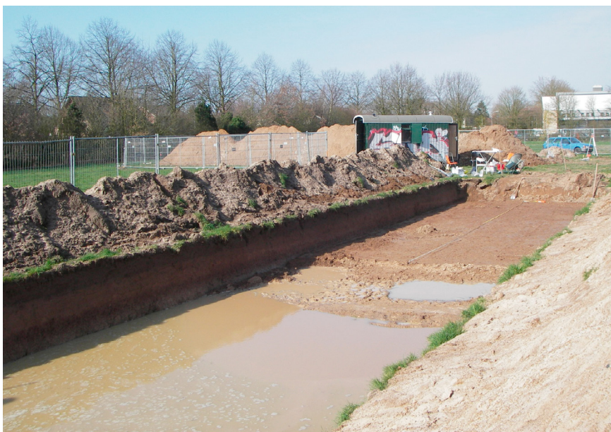
Figuur 3.1. De werkzaamheden werden in januari gestaakt vanwege de regen en de slechte waterdoorlatendheid van de bodem. BAMN
